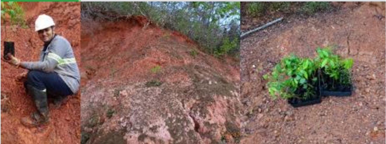
Fotos 4 a 9: Recuperación de erosión realizada en la torre 710 del tramo COL-RGV – LT 500 kV ATEII LO 579/2006 (ATE II)
