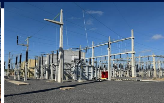
SÃO PEDRO Banco de Autotransformador
